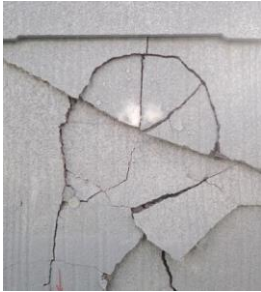
氷の衝突により割れたカラーベスト
